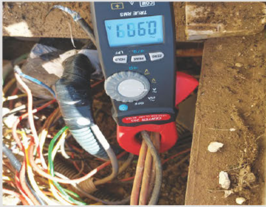
صورة #10: تسرب كهربائي مرتفع للأسلاك
